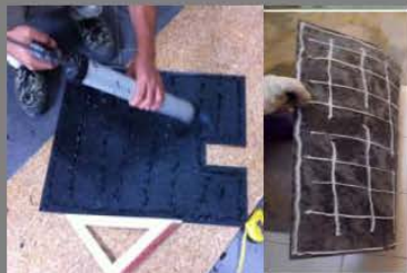
(6) 石材背面可以用免钉胶、结构胶等施工， 打胶注意不要太靠近产品边缘，以免硅胶挤压溢出
